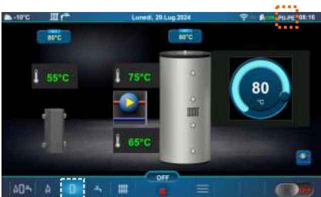
Schermata del serbatoio di accumulo (PII-PE)
