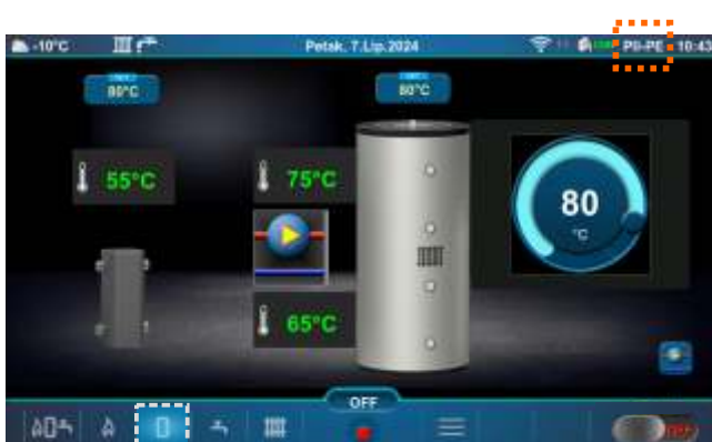
Zaslon akumulacijskog spremnika (PII-PE)
